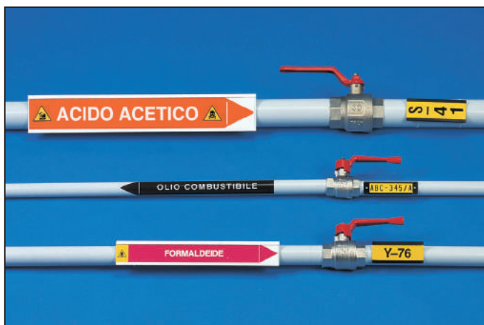
tubazioni con sistema TLS
